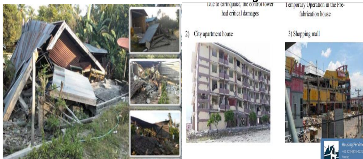
Gambar II.10 Foto Kerusakan Rumah Warga Rusak Berat
