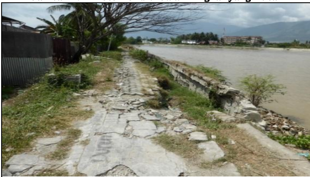
Gambar II.11 Foto Kondisi Jalan Lingkar yang Rusak
