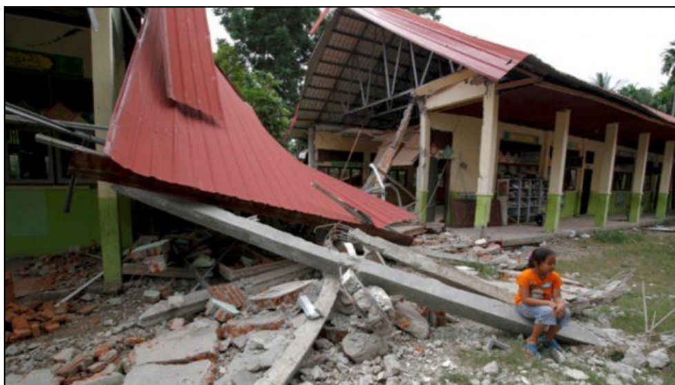
Gambar 3.8 Kerusakan salah satu sekolah di Kab. Lombok Utara
