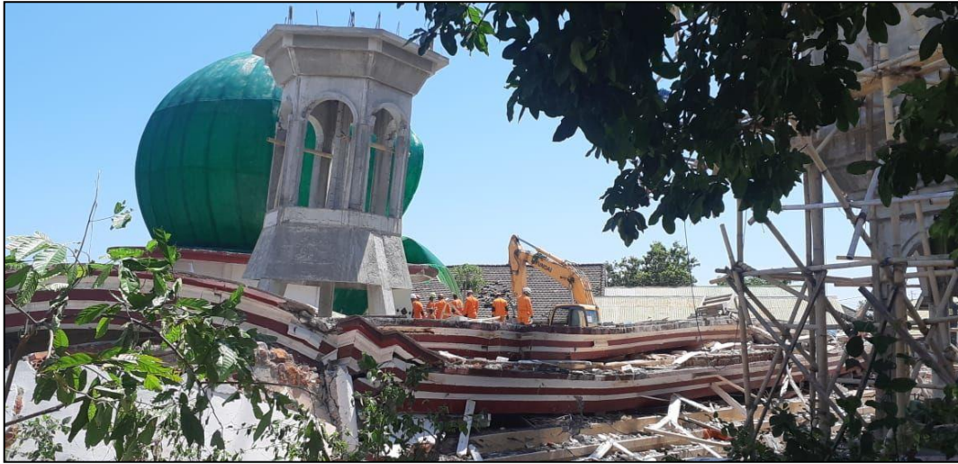
Gambar 3.10 Kerusakan Masjid lading-lading
