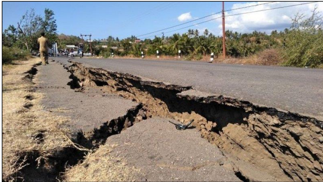
Gambar 3.6 Kerusakan ruas jalan nasional di Kecamatan Gangga
