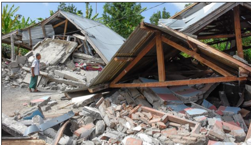
Gambar 3.5 Kerusakan rumah salah satu warga di Kab. Lombok Utara
